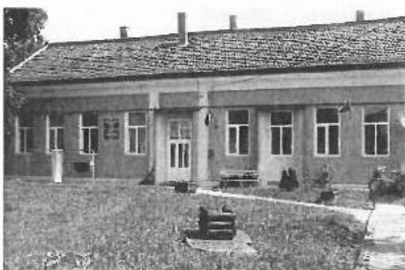
Fig. 21c. Starea infrastructurii educaționale la nivelul UAT Carei - Grădinița cu program prelungit nr. 1. Sursă: Google maps
