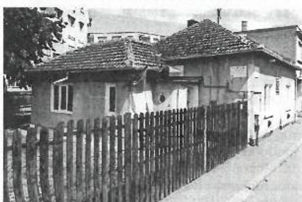
Fig. 21d. Starea infrastructurii educaționale la nivelul UAT Carei - Grădinița cu program prelungit nr. 10. Sursă: Google maps
